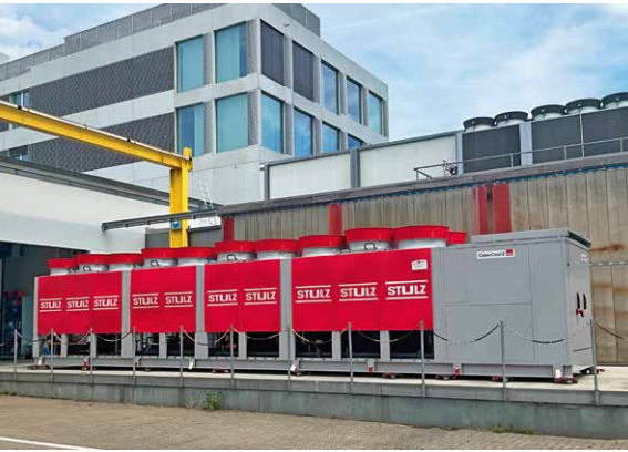
Modernisierung der Kälteversorgung: Drei Kältemaschinen sorgen zukünftig für mehr Energieeffizienz und Versorgungssicherheit.
